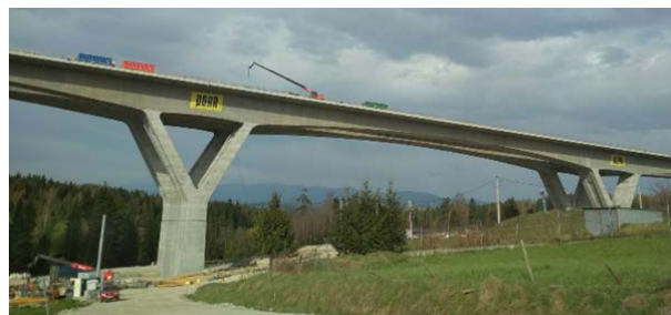
Fig. 6. A fragment of the longest flyover on the Skomielna Biała–Chabówka section III (992 m long; largest: span the span 140 m, height of the support together with the supporting structure 49.4 m) [source: 12] Rys. 6. Fragment najdłuższego wiaduktu na III odcinku Skomielna Biała – Chabówka (992 m długości; największe: rozpiętość przęsła 140 m, wysokość podpory wraz z konstrukcją nośną 49,4 m) [źródło: 12]
