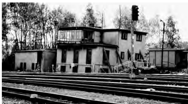
Fig. 2. Defects of transport-related civil structures: building of signal box – drop Rys. 2. Uszkodzenia konstrukcji cywilnych związane z transportem: budowa skrzynki sygnalizacyjnej
