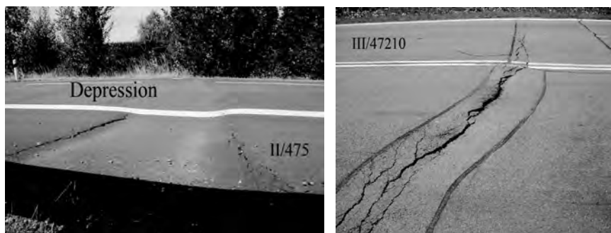
Fig. 3. Road defects Rys. 3. Uszkodzenia dróg
