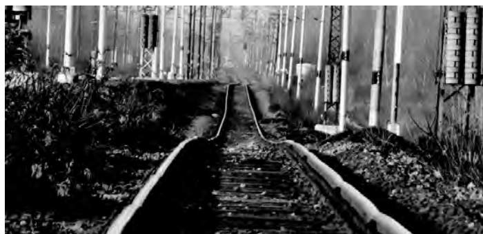
Fig. 4. Defects in rail alignment Rys. 4. Uszkodzenia torów
